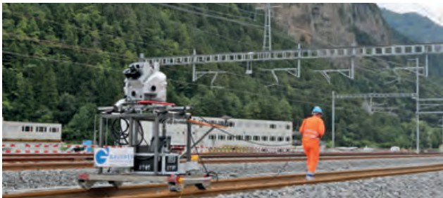
360° Blick des Messsystems (ganz oben) Pegasus:Two auf dem Gleiswagen (oben) Punktwolke mit DGM Auswertung (rechts)
